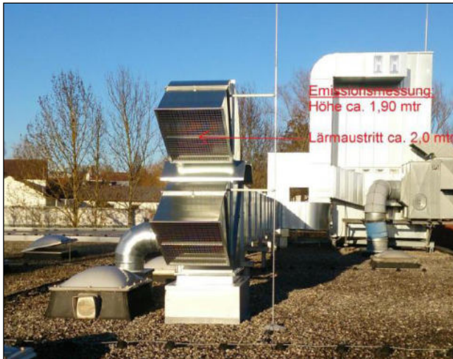
Abbildung 10: Neue (verlegte) Ausblasöffnung Schreinerei
