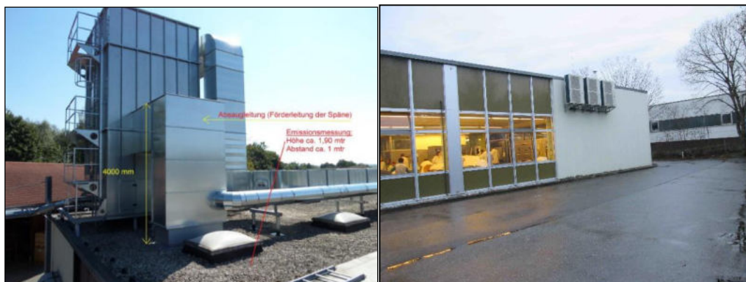
Abbildung 9.1 und 6.2: Neue (schallgedämmte) Filteranlage (links) und neue Kühlaggregate (rechts)
